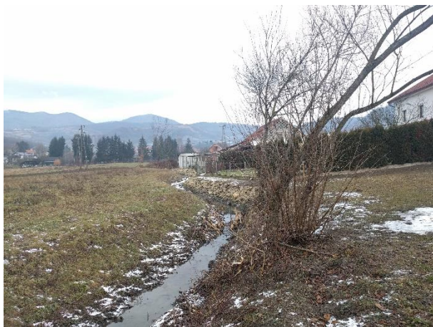
Fotografija 1-8: Šemnica, postojeće stanje; stara obaloutvrda na lijevoj obali oko stac. km 2+638 (u tabl. 1-1 Obaloutvrda 1)
