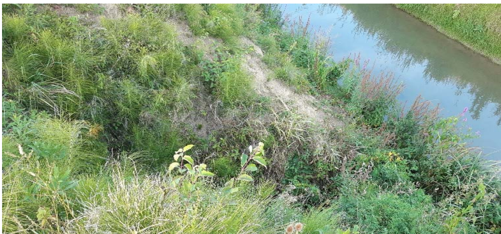
Fotografija 2-33: Propust, na desnoj obali Kosteljine, promjera cijevi 80 cm, nalazi se na stac. km \approx 2+509 (u Tablici 2-1 je opisan kao Propust 13)
