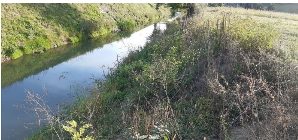
Fotografija 2-13: Odron na desnoj obali Kosteljine, duljina odrona je L=4,0 m, denivelacija terena i materijala na odronu oko 2-3 m, nalazi se na stac. km \approx 1+898 (u Tablici 2-1 je opisan kao Odron 4)
