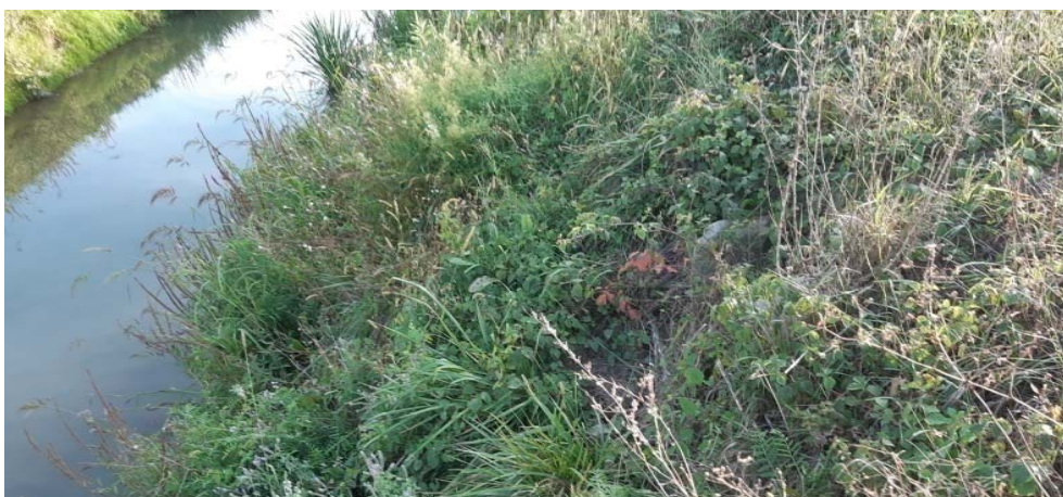
Fotografija 2-16: Propust, izrazito obrastao travom, betonska cijev promjera 80 cm na desnoj obali Kosteljine, nalazi se na stac. km \approx 1+943 (u Tablici 2-1 je opisan kao Propust 4)
