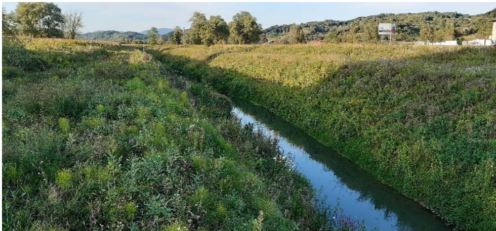
Fotografija 2-34: Odron, na desnoj obali Kosteljine, nalazi se na stac. km \approx 2+533 (u Tablici 2-1 je opisan kao Odron 11)
