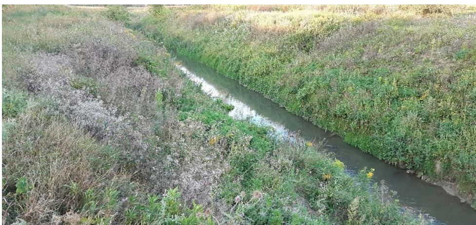
Fotografija 2-43: Odron, na desnoj obali Kosteljine, nalazi se na stac. km \approx 2+683 (u Tablici 2-1 je opisan kao Odron 16)
