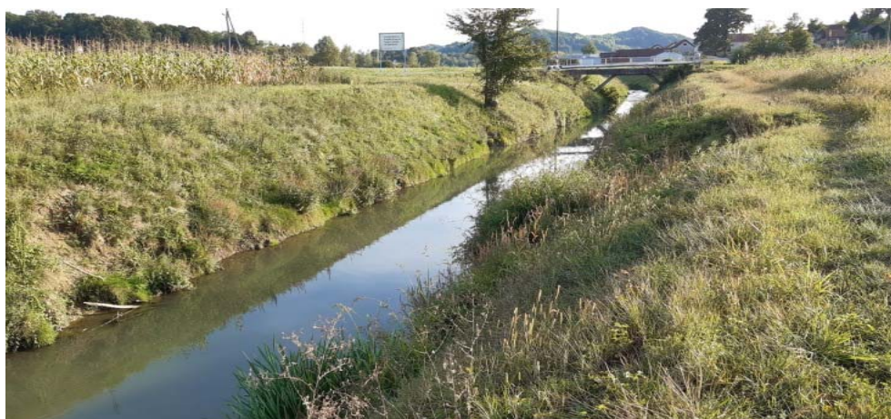
Fotografija 2-9: Odron na desnoj obali Kosteljine, uzvodno od Mosta 1, duljina odrona je L \approx 50 m i na stac. km \approx 1+832 (u Tablici 2-1 je opisan kao Odron 1; ovdje je jasno vidljivi i Odron 3 na lijevoj obali)
