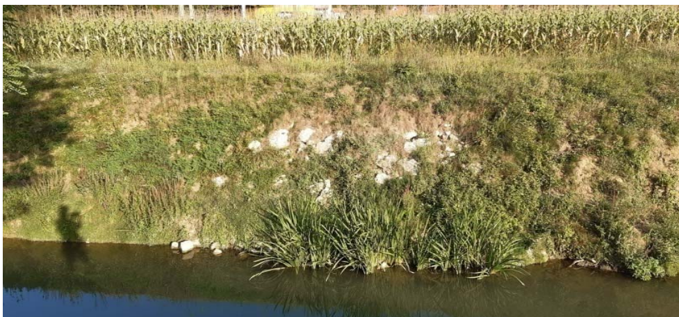
Fotografija 2-12: Ostaci obaloutvrde na lijevoj obali Kosteljine, također vidljiv Odron 3, na stac. km \approx 1+865 (u Tablici 2-1 je opisana kao Obaloutvrda 3)
