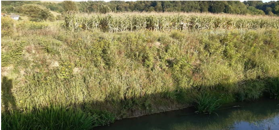
Fotografija 2-23: Odron, na desnoj obali Kosteljine, dubine je 2-3 m, nalazi se na stac. km \approx 2+150 (u Tablici 2-1 je opisan kao Odron 7)
