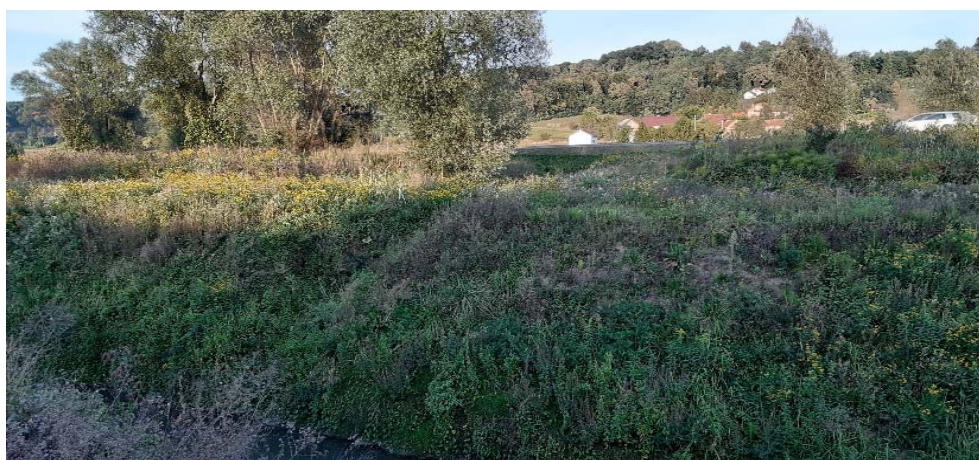
Fotografija 2-44: Propust, na lijevoj obali Kosteljine, promjera cijevi 100 cm, nalazi se na stac. km \approx 2+695 (u Tablici 2-1 je opisan kao Propust 16)
