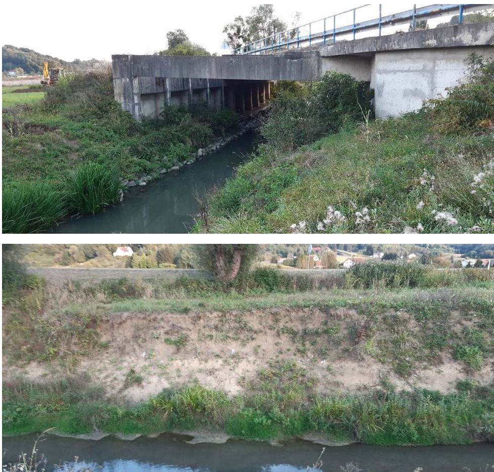
Fotografije 2-53 i 2-54: Most, na kraju obuhvata zahvata, nalazi se na stac. km \approx 3+012 (u Tablici 2-1 je opisan kao Most 2)
