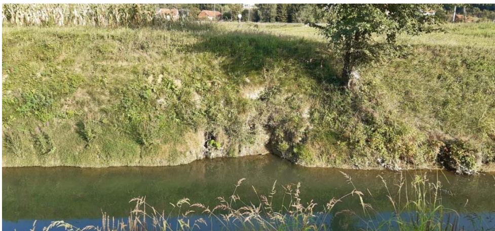
Fotografija 2-10: Odron na lijevom pokosu Kosteljine, podlokavanje lijeve obale, u ravnini sa odronom na desnoj obali Odronom 1, duljina odrona je L=2,5 m i na stac. km \approx 1+833 (u Tablici 2-1 je opisan kao Odron 2)
