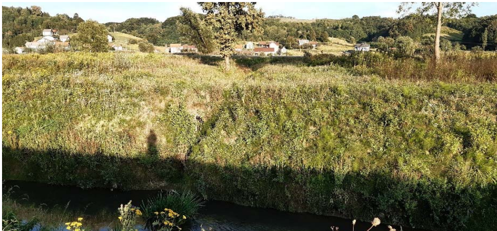
Fotografija 2-29: Propust, na lijevoj obali Kosteljine, promjera cijevi 100 cm, nalazi se na stac. km \approx 2+406 (u Tablici 2-1 je opisan kao Propust 10)
