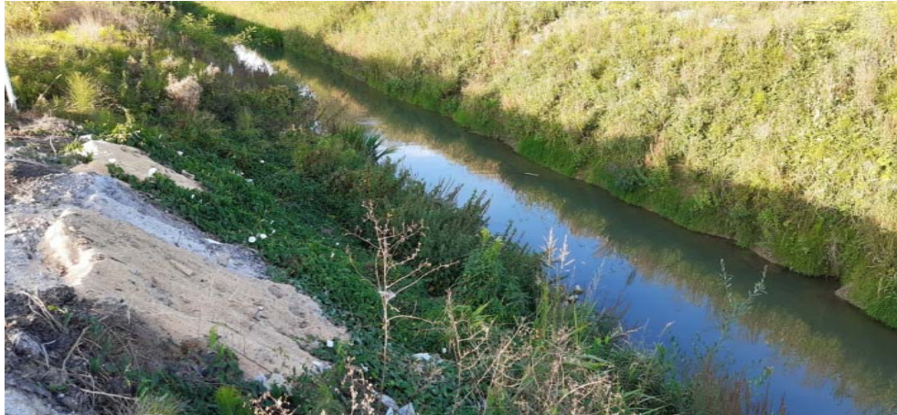
Fotografija 2-25: Odron, na desnoj obali Kosteljine, odronulo se je oko 1,5-2,5 m zemljanoga materijala u odnosu na nivo od okolnoga terena, nalazi se na stac. km \approx 2+214 (u Tablici 2-1 je opisan kao Odron 9)
