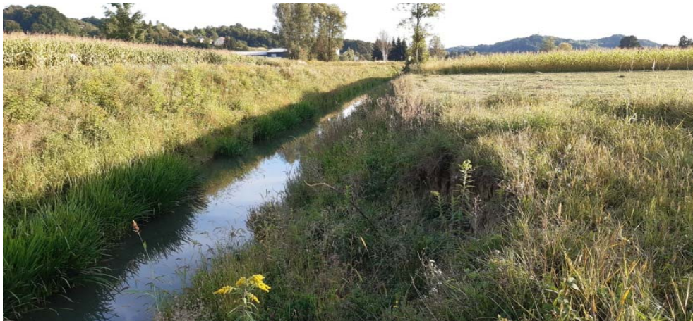
Fotografija 2-24: Odron, na lijevoj obali Kosteljine, plići odron i teže se nazire uslijed obraslosti travom, nalazi se na stac. km \approx 2+195 (u Tablici 2-1 je opisan kao Odron 8)
