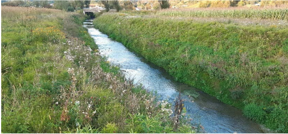
Fotografije 2-49 i 2-50: Odron, na desnoj obali Kosteljine, nalazi se na stac. km \approx 2+933 i duljine je L \approx 60 m, u Tablici 2-1 je opisan kao Odron 19)
