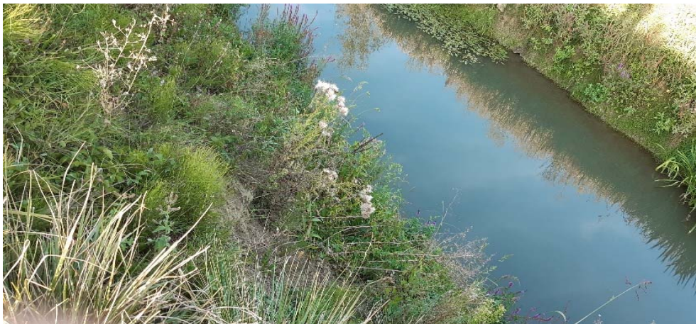
Fotografija 2-26: Odron, površinski na desnoj obali Kosteljine, na nalazi se na stac. km \approx 2+338 (u Tablici 2-1 je opisan kao Odron 10)
