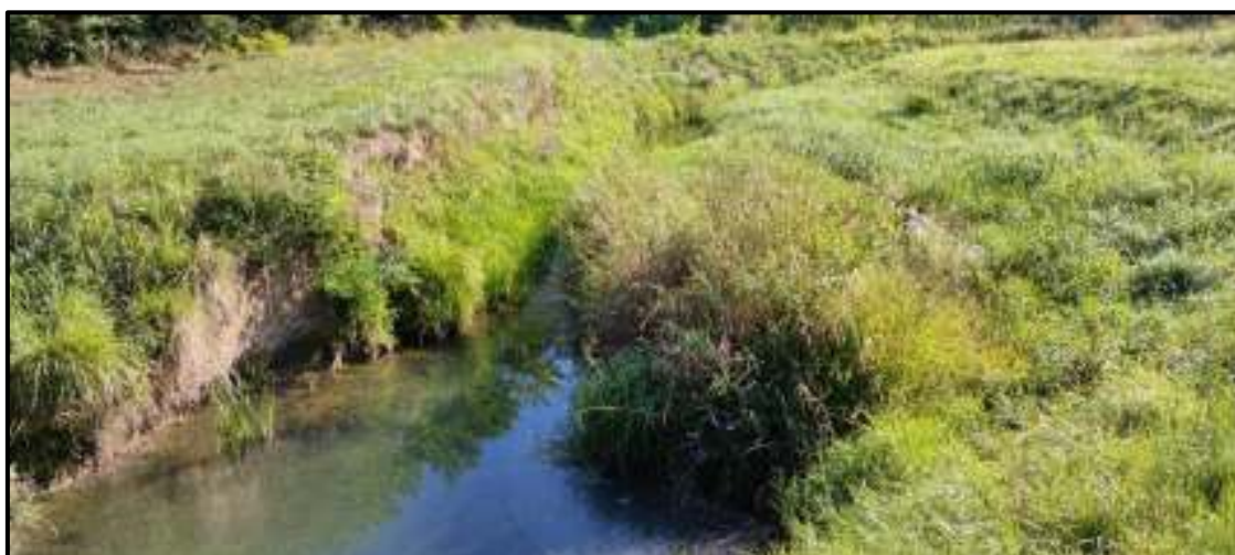
Slika 2.1-4. Karakteristični izgled postojećeg korita potoka Topličina: obrušavanje materijala na pokosima (izvor: Viacon, 2022.)
