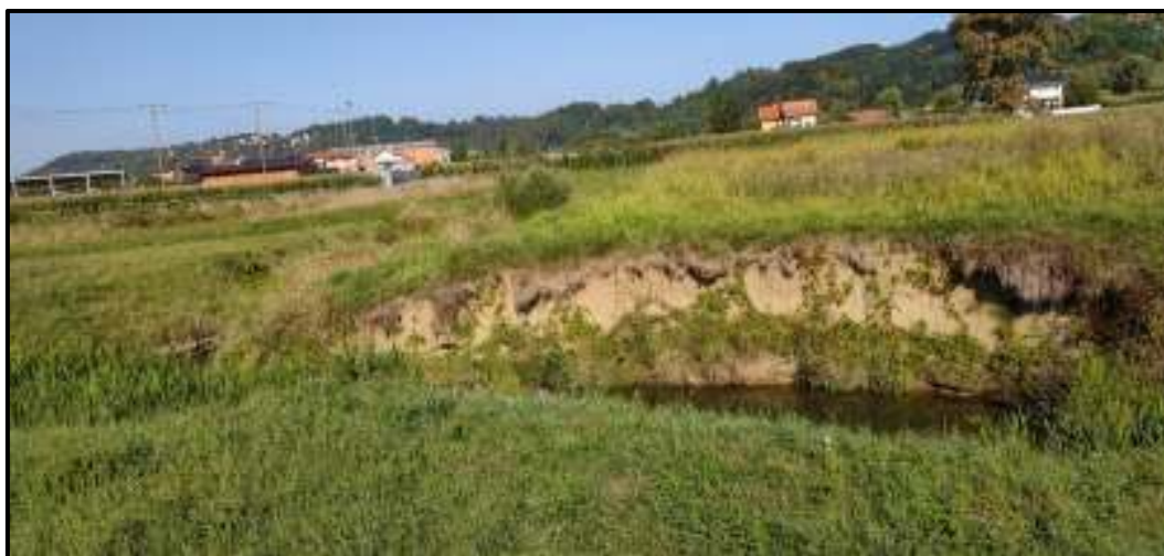
Slika 2.1-6. Karakteristični izgled postojećeg korita potoka Topličina: erozije i odroni obala u konkavnim krivinama (izvor: Viacon, 2022.)
