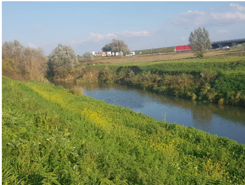
Slika 3. Erozijsko djelovanje vode na pokose korita – stacionaža 23+710
