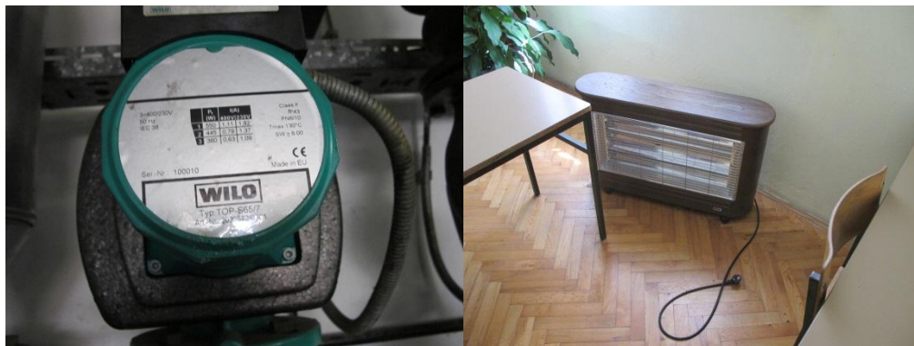
Slika 1.29 Prikaz pumpe iz kotlovnice i električne grijalice u školi
