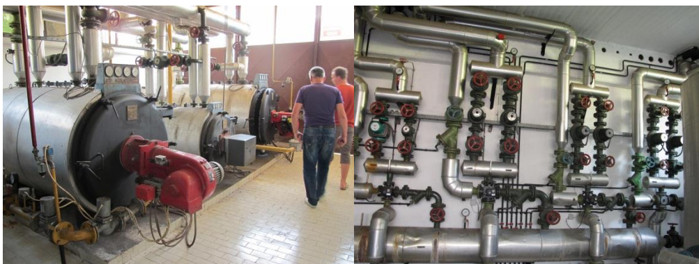
Slika 1.7 Prikaz kotlova i razvod sustava grijanja
