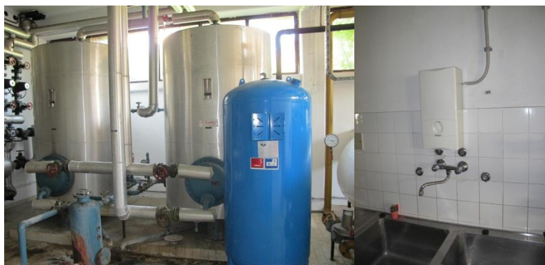
Slika 1.12 Prikaz akumulacijskih bojlera u kotlovnici i električnog bojlera u kuhinji
