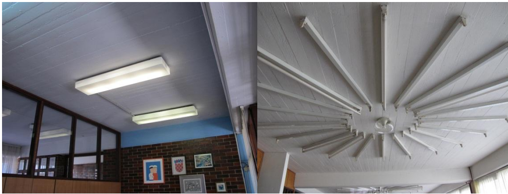
Slika 1.20 Prikaz sustava unutarnje rasvjete
