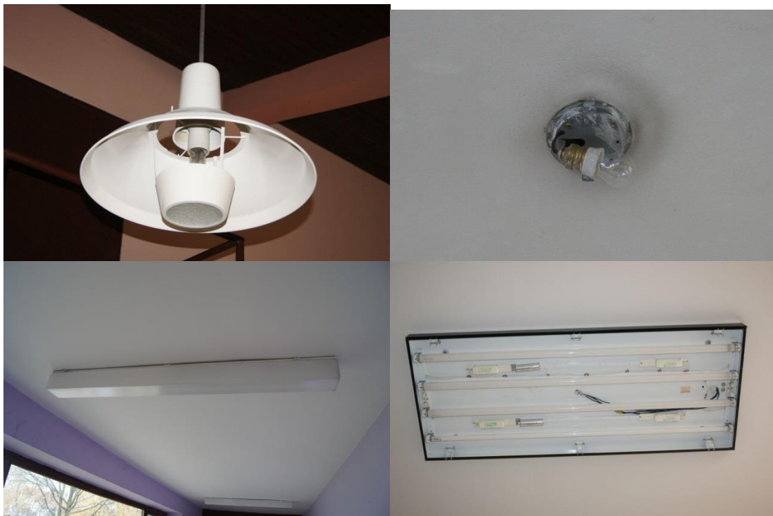
Slika 1.13 Prikaz sustava unutarnje rasvjete
