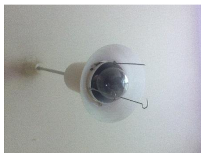
Slika 1.13 Prikaz sustava unutarnje rasvjete
