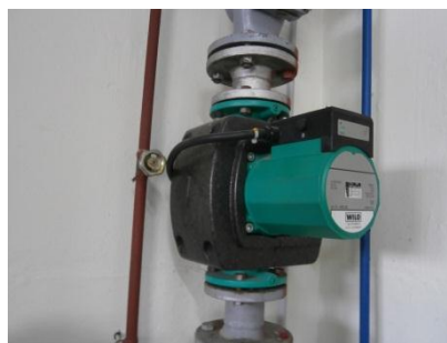
Slika 1.20 Prikaz pumpe iz kotlovnice
