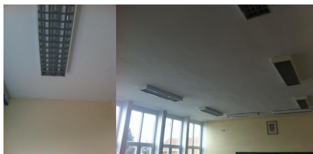
Slika 1.16 Prikaz sustava unutarnje rasvjete
