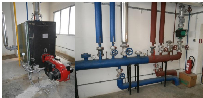
Slika 1.6 Prikaz kotlova i razvod sustava grijanja
