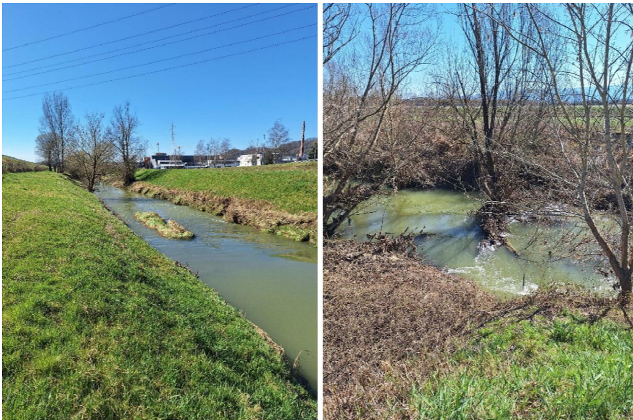
Sl. 2.2-3: Nanosi materijala (otok) stac. 2+450 i stabla u koritu vodotoka stac. 2+350 potoka Krapinica koja zadržavaju naplavine
