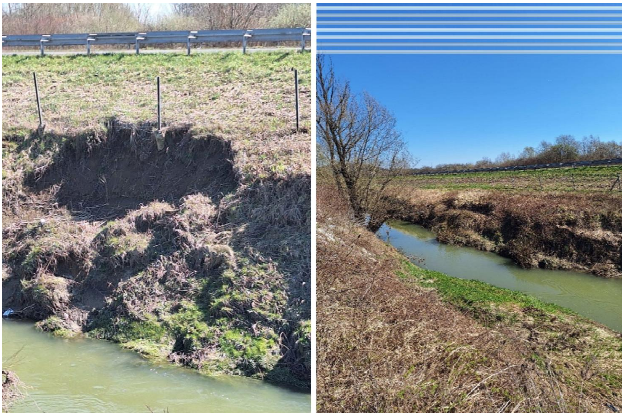
Sl. 2.2-1: Erozijski i školjkasti lomovi na pokosu, strana prema autocesti Zagreb-Macelj
